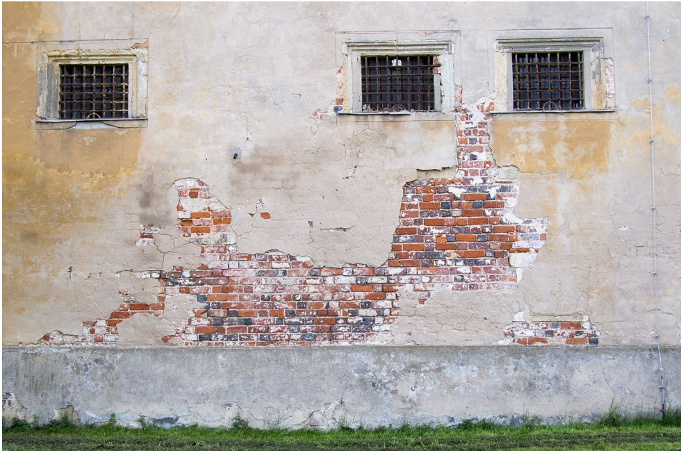
Abbildung 110. Prettin, Schloss Lichtenburg, Westflügel (B), südlicher Teil der Westfassade, Backsteinmauerwerk, 14. Jahrhundert, mit Fenstern aus dem 16. Jahrhundert
