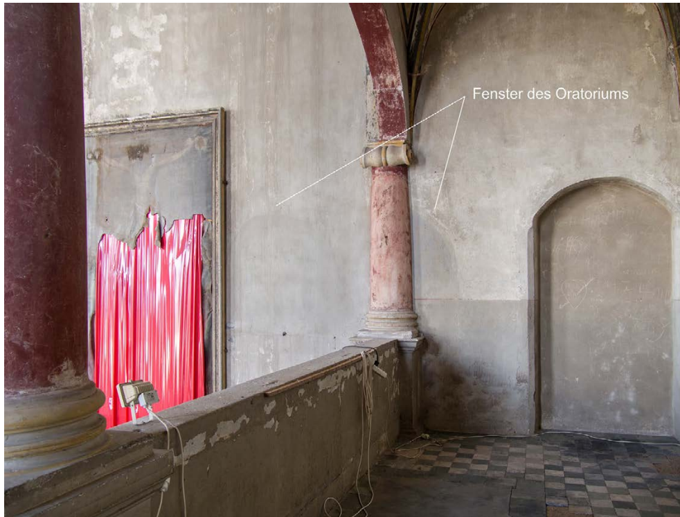
Abbildung 144. Prettin, Schloss Lichtenburg, Schlosskapelle, untere Empore von 1577–1582, ehem. Fenster des Oratoriums (1.35) von 1565–1577 (?), vermauert zwischen 1812 und 1851
